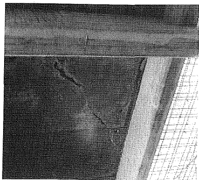
Figur 3.42. Eksempel på revner i et betondæk, fremkaldt af temperaturforskelle i den hærdenne beton; foto viser et nystøbt betonribbedæk set nedefra.
