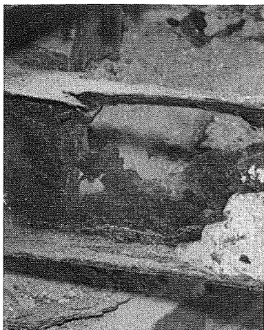
Figur 6.34. Jern er et uædelt metal, der står lavt i den elektrokemiske spændingsrække. Jern danner derfor hyppigt anode i korrosionsceller, hvorved det tæres galvanisk. Jernemner, der påvirkes af fugt og luft, kan på kort tid nedbrydes ved galvanisk korrosion. Foto viser et genemtæret udliggerjern fra en altan-konstruktion.
