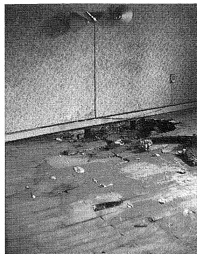
Figur 5.28. Parketgulv, der er nedbrudt af ægte hussvamp. Årsag: en ydermur har opsuget fugt, hvorved den relative luftfugtighed under gulvbelægningen er øget til et niveau, hvor angreb af hussvamp kan sætte ind. Efter få år er gulvtræets underside nedbrudt af svampens mycelium.
