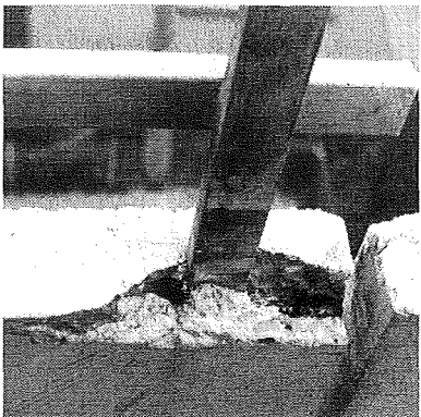
Figur 4.2. Korrosion af armeringsjern i en altanbrystning afsprænger betonen; forebyggelse af korrosionsskader i bygværker forudsætter viden om kemiske reaktioners retningsbestemthed.
