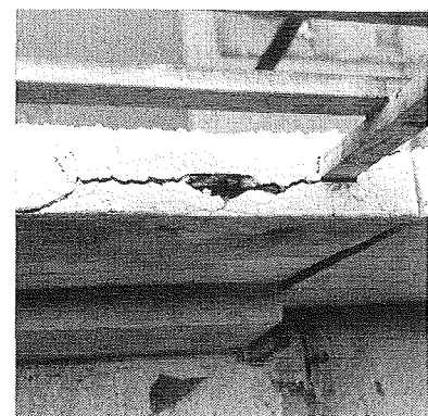
Figur 1.44. Armeringsjern, der udsættes for fugt og ilt i et pH-neutralt miljø, vil hurtigt korrodere. Da de dannede korrosionsprodukter har et større volumen end det omdannede jern, afsprænges betonen over armeringen.
