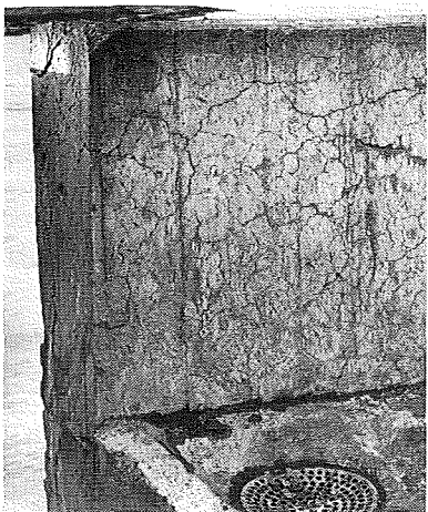
Figur 4.1. Nedbrydning af betonelementer pga. alkalireaktioner i det benyttede tilslag; arbejdet med at forbedre betons holdbarhed kræver viden om kemiske reaktioners retningsbestemthed.
